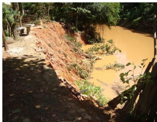
Figura 6-19 - Trecho do rio com ocorrência de desmoronamento de talude – Coordenadas UTM 234.792S/ 7.748.880S
