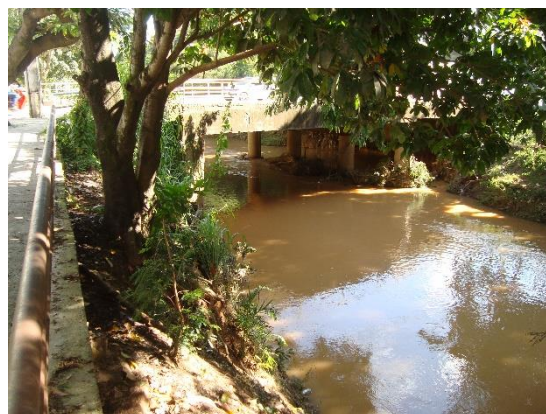
Figura 1-2 – Aspecto de uma das pontes sobre o Rio Pardo na sede de Lúna
