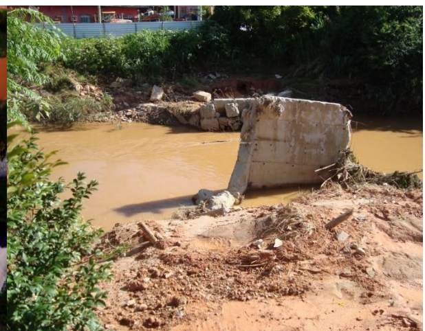
Figura 6-26 - Obstrução do rio pela ponte desmoronada – Coordenadas UTM 235.537E / 7.747.116S
